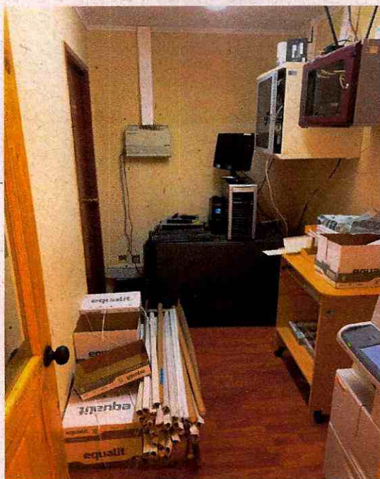
Sala de servidores con materiales inflamables y ausencia de controles humo, agua, humedad.
