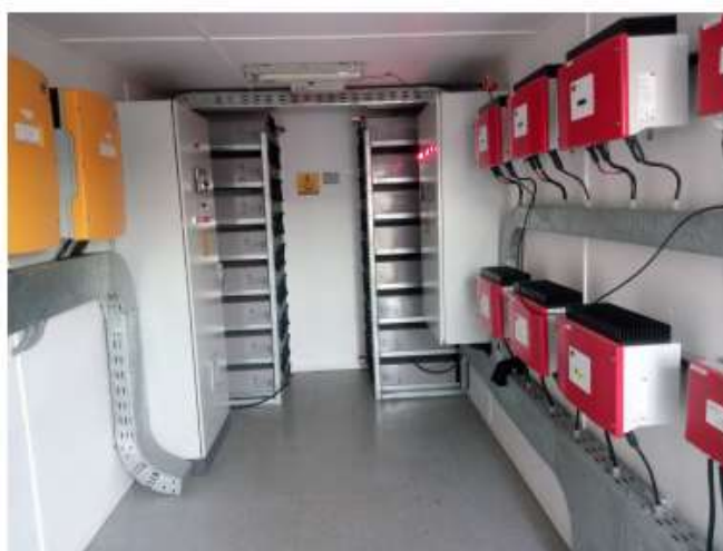
Sala eléctrica de generación renovable Bahía Azul.
