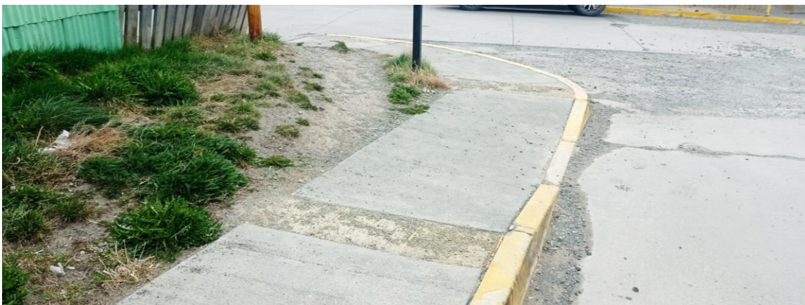
Calle Jorge Cárdenas esquina Juan Fierro, no se observa reposición de baldosas podotactiles.
