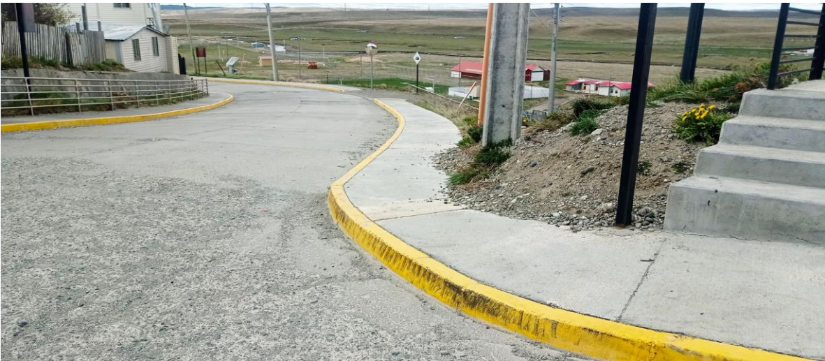
Calle Juan Fierro, no se observa el mejoramiento de las pinturas de soleras
