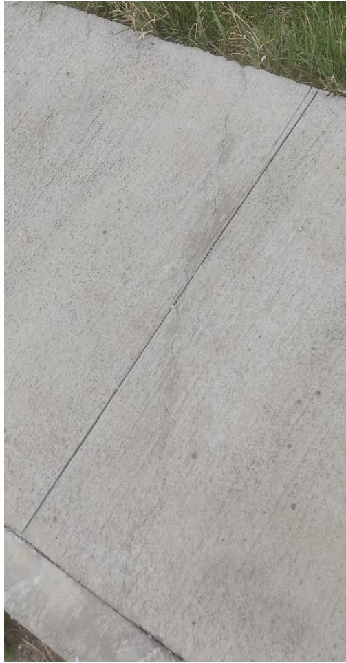
Grieta en P.99 y P.100 del plano de estado de veredas adjunto.
