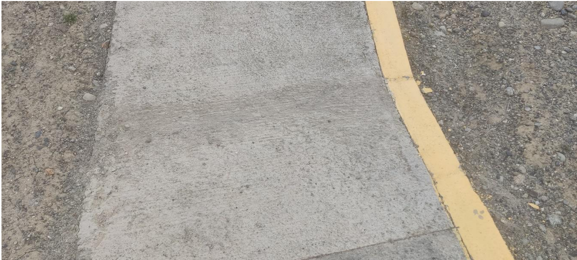
Grieta en P.71 del plano de estado de veredas adjunto.
