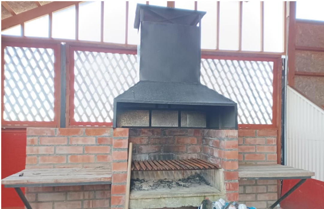
Fogones sin la ejecución de las partidas de lava fondos y extensión de campanas al exterior.
